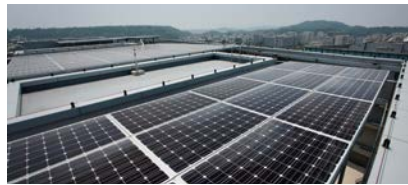
(상암DC) 태양광 발전시설
