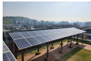
상암 데이터센터 태양광 발전시설
