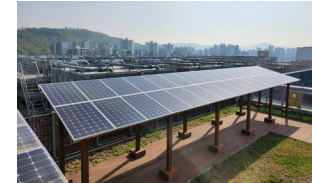
상암 데이터센터 태양광 발전시설
