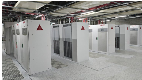
수원 데이터센터 UPS(무정전) 전원공급 장치
