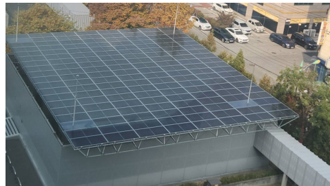
태양광 발전설비 설치 후 전경
