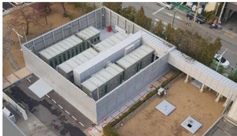
기존 옥외 수배전실 전경
