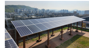
상암 데이터센터 태양광 발전시설
