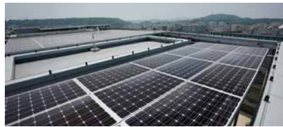
(상암DC) 태양광 발전시설
